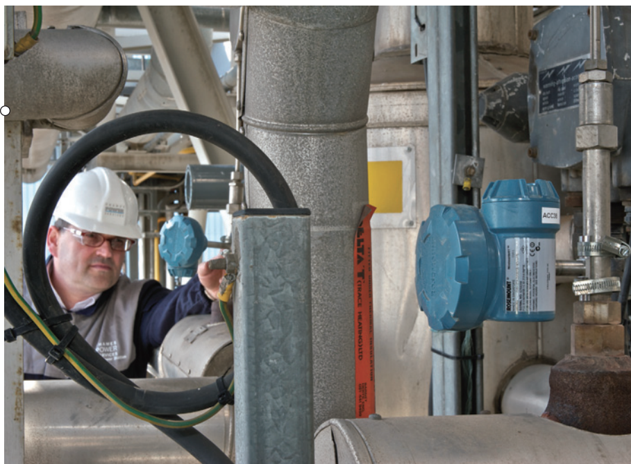
图 2：危险区域的仪表和接线系统必须定期检查。图中所示为在外观检查过程中，一个经过认证的技术人员在查找明显的故障。
