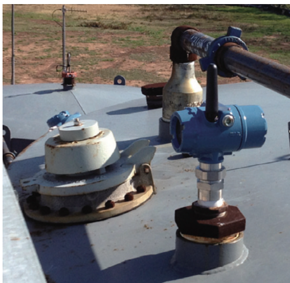
图 3：电池供电的现场设备，例如无线 HART 的液位传感器可以用在危险环境中，包括存储可燃物质的储罐。
