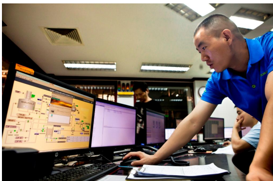
图：工厂发酵控制室操作人员正在使用 BRAUMAT 系统
