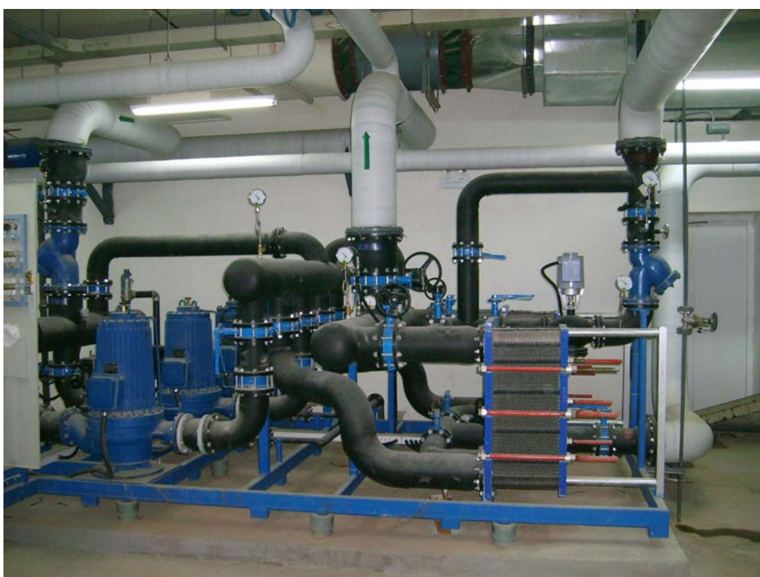
照片 6: 供暖系统中的热交换器
