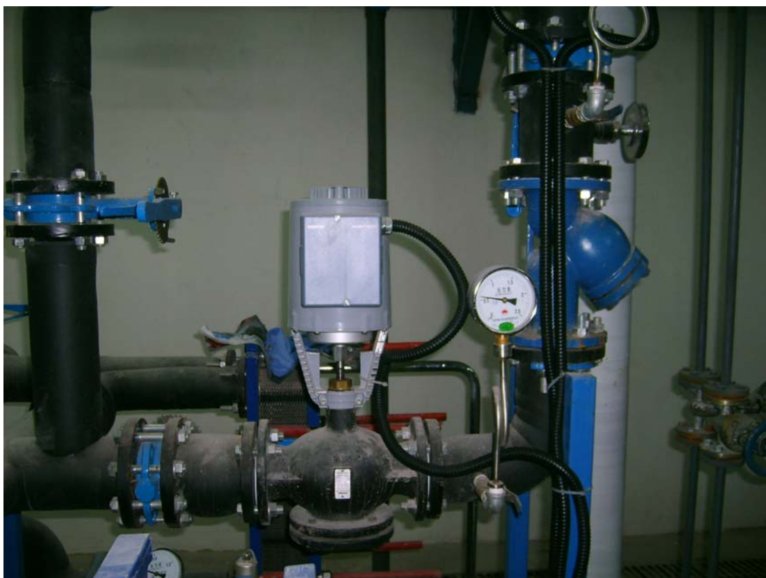
照片 5: 热交换系统中的电动流量阀
