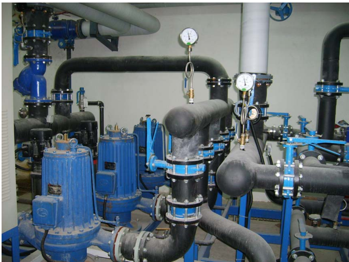
照片 4：三台供热循环泵及管网示意图
